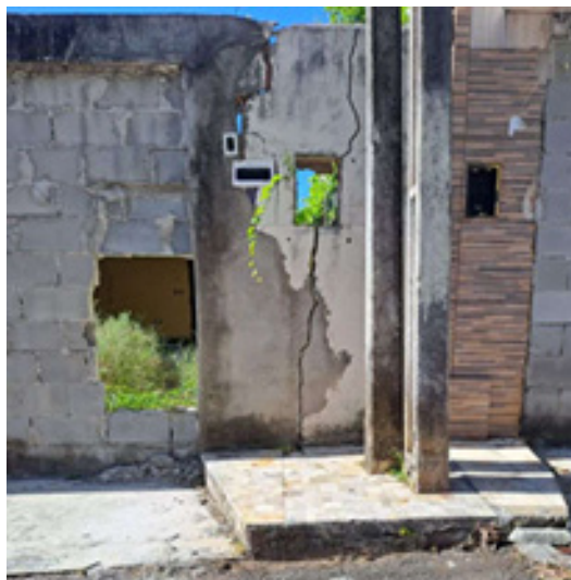
Imagem 2 - Rachadura em casa do bairro Pinheiro
