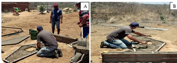
Figura 11. Preenchimento da frontal "B" com argamassa (A); colocação da armação de ferro 4.2 para reforço na peça (B).
