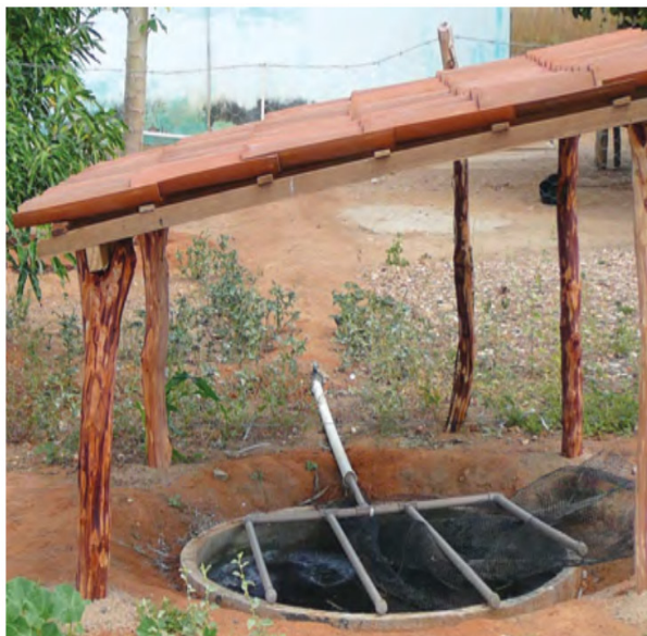
Figura 11. tanques de tratamento e reuso de água gerada nas residências rurais que exclui a água do vaso sanitário.
