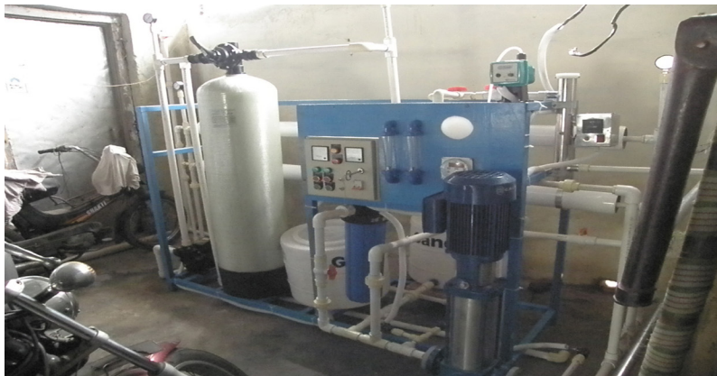
Figura 5 - Sistema de dessalinização por osmose reversa com capacidade para 1000 litros de água por dia.
