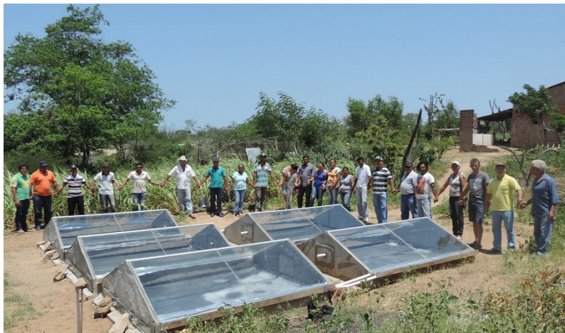
Figura 6: Instalação de dessalinizadores solar em campo.
