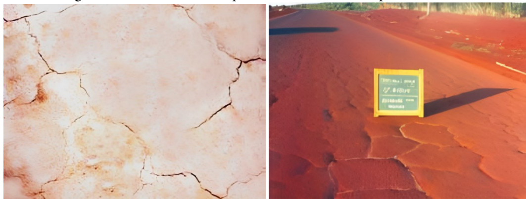
Figura 14: Solo laterítico em processo de trincamento por “cura ao ar”
