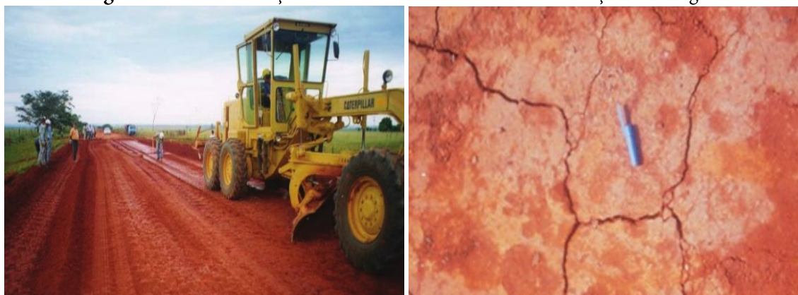
Figura 320: Conformação final da base e trincamento em função da secagem
