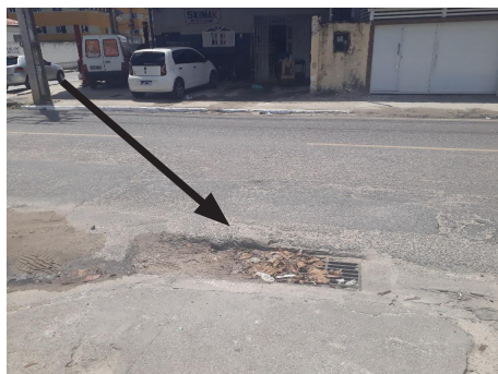
Figura 6 – Presença de resíduos e sedimentos sobre a área de escoamento da água
