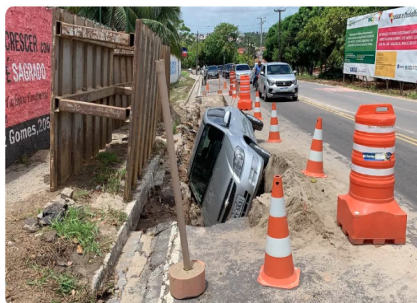
Figura 18 – Carro cai em vala de obra da CAGEPA
