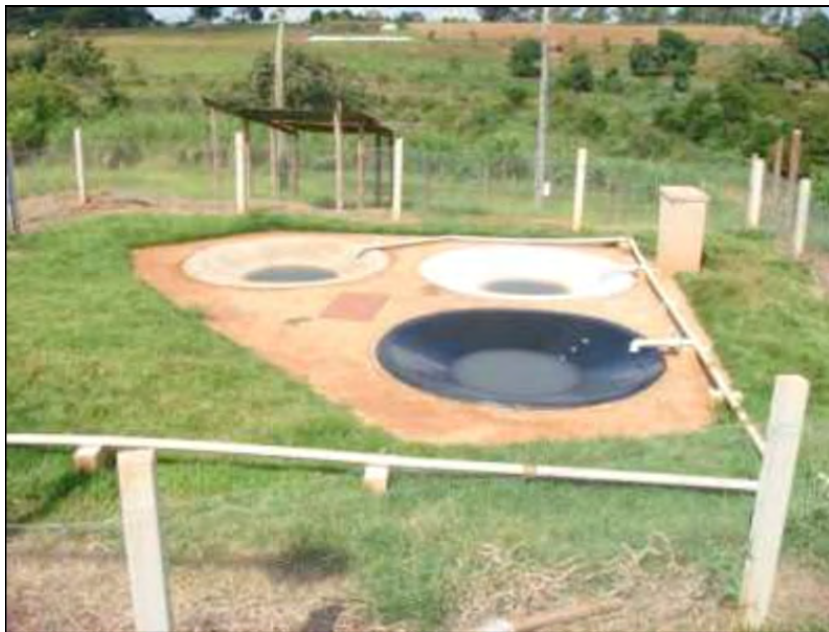
Figura 4 - Sistema para desinfecção solar de águas residuárias domésticas Fonte: Queluz e Sánchez-Román (2014).
