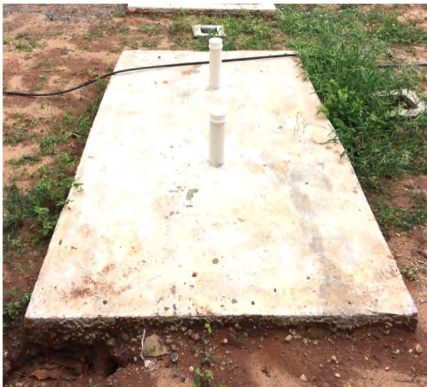
Figura 6 - Vista superior do tanque séptico Fonte: Arquivo dos pesquisadores (2021).
