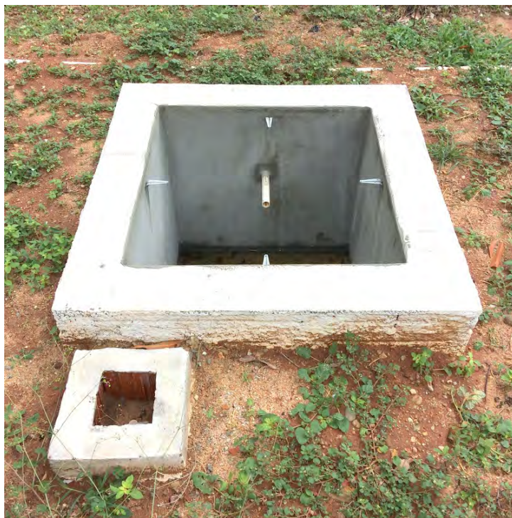
Figura 11 - Vista superior do reservatório Fonte: Arquivo dos pesquisadores (2021).
