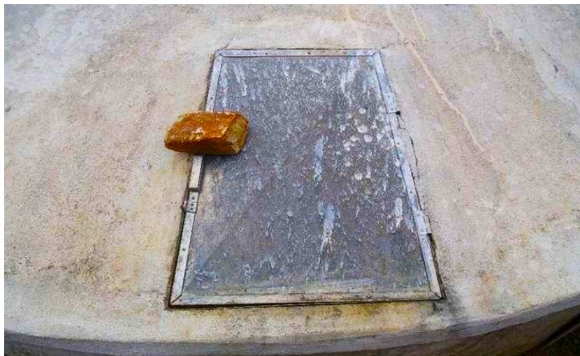
Figura 3 – Cisterna fechada com tampa de metal
