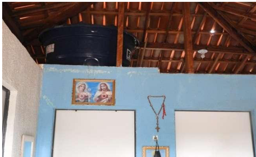
Figura 26 – Caixa d'água em casa na Vila Irapuá I
