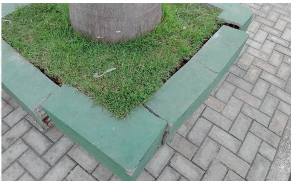
Figura 5: dano estrutural causado por uma palmeira imperial.
