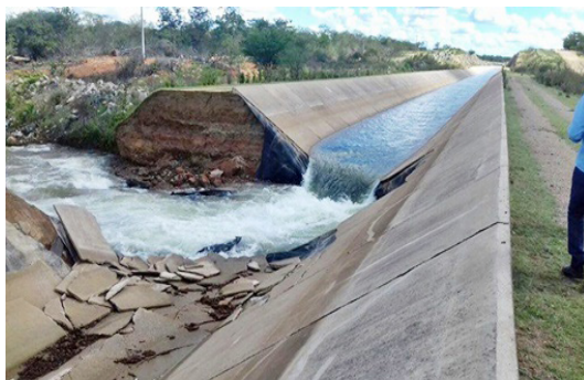
Figura 2 - Rompimento do canal
