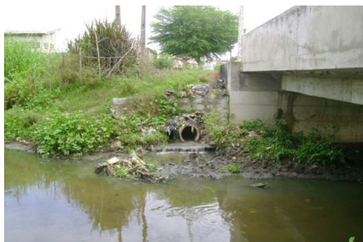
Imagem 3 - Esgoto deságua no rio Preto
